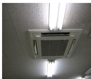
省エネ空調機の導入
