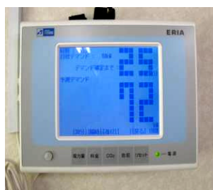
電力計測器による電力の統括管理
